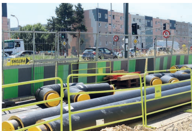
Grâce à la géothermie, les résidents raccordés pourront bénéficier d'un chauffage à moindre coût.
