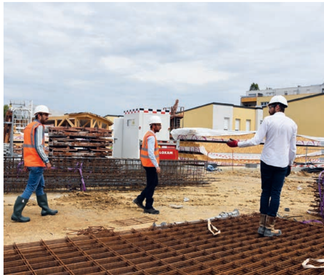
La Ville investit pour améliorer le service public. Ici le chantier de la nouvelle école Rosa-Parks.
